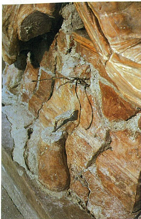
Fig. 2 - Esempio di perni e fili metallici, ampiamente ossidati, inseriti come rinforzo dell'opera durante il precedente restauro del XIX secolo.
